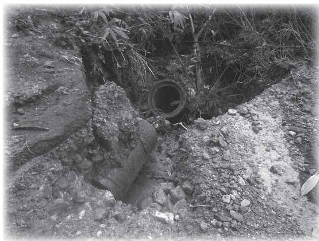
一部の町道では陥没等も発生しました
