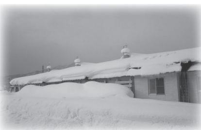
屋根の上の除雪は特に危険が伴います
