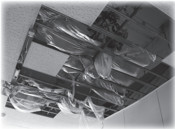
未使用教室は未修繕の天井も散見されました
