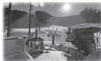
リフトは経年劣化が激しい状況です
